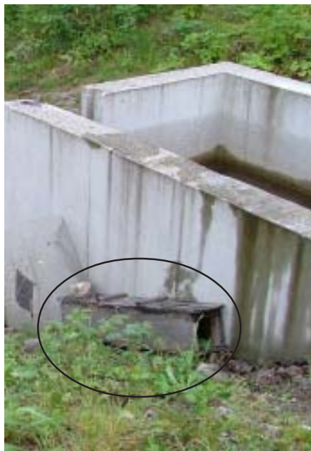
Minkfälla intill damm.
